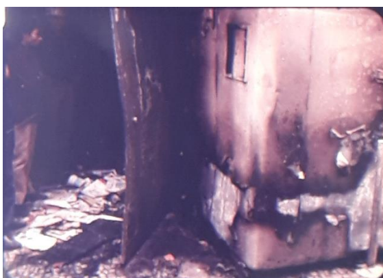
Imagem 11 - O incêndio afetou toda a estrutura da banca
